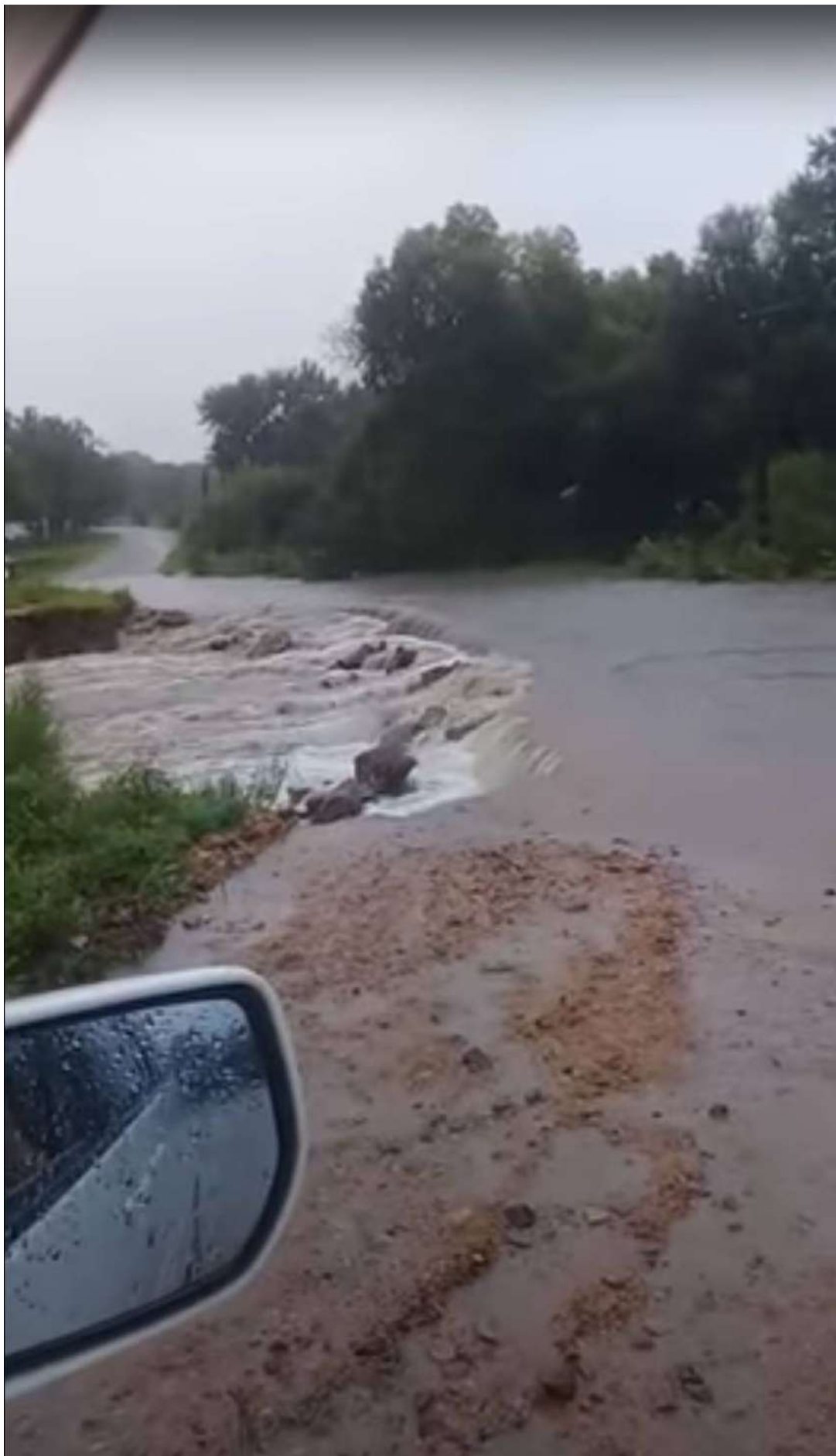
Фото 8. Перелив ручья Б.н.1 через насыпь объезда с трубой после дождя летом 2019 года. Вид с левого на правый берег (лето 2019 г).
