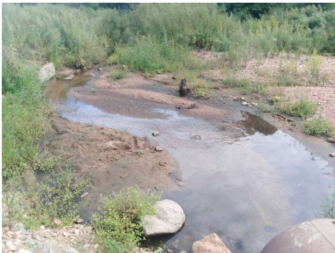
Фото 2. Нижний бьеф водопропускной трубы на объезде смытого моста. Вид вниз по течению (лето 2020 г).
