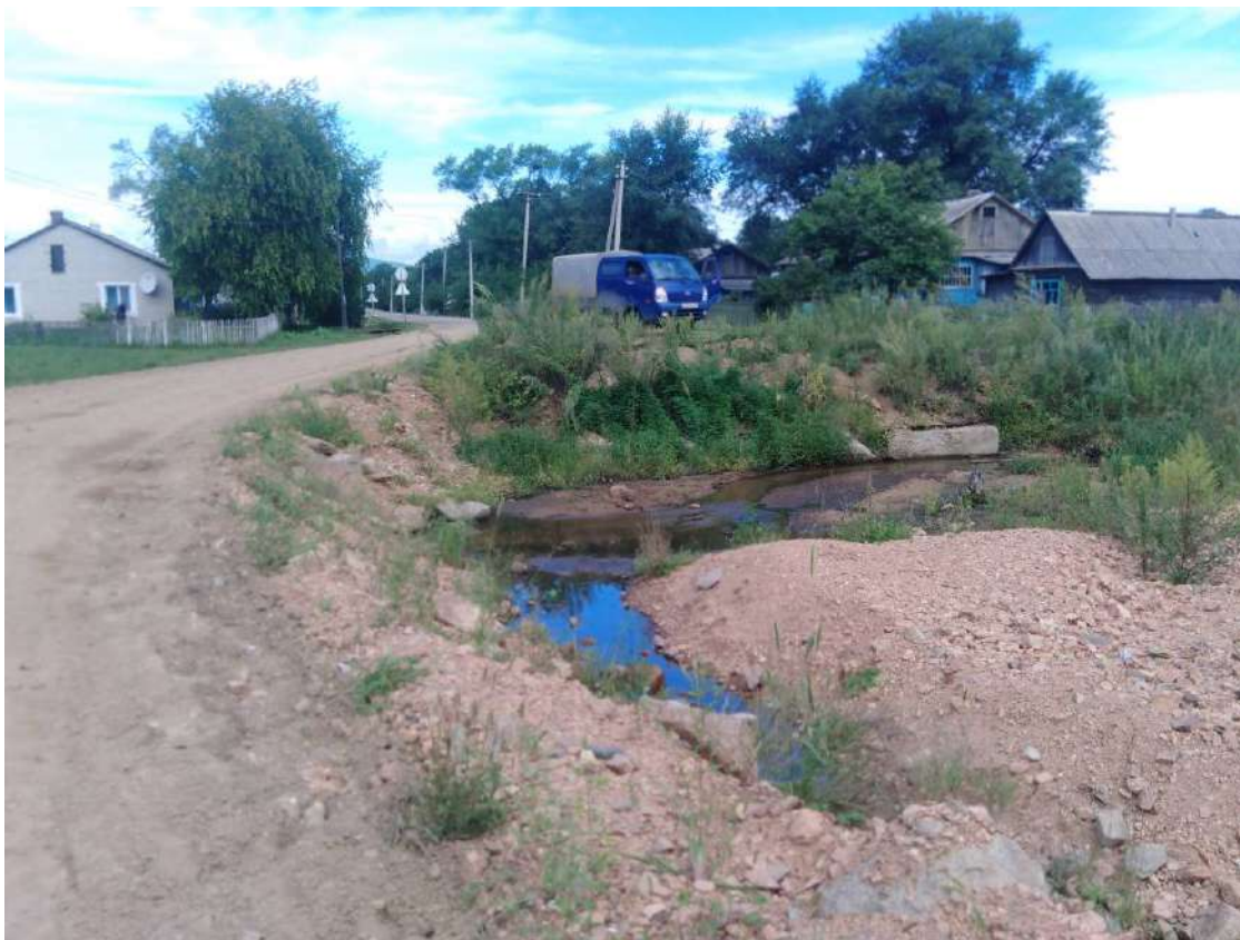
Фото 3. Участок смытого в 2015 году моста через ручей Б.н. на км 13+940 подъезда к с. Духовское от Уссурийск – Пограничный. Вид с насыпи объезда на левобережный подход к мосту (лето 2020 г).
